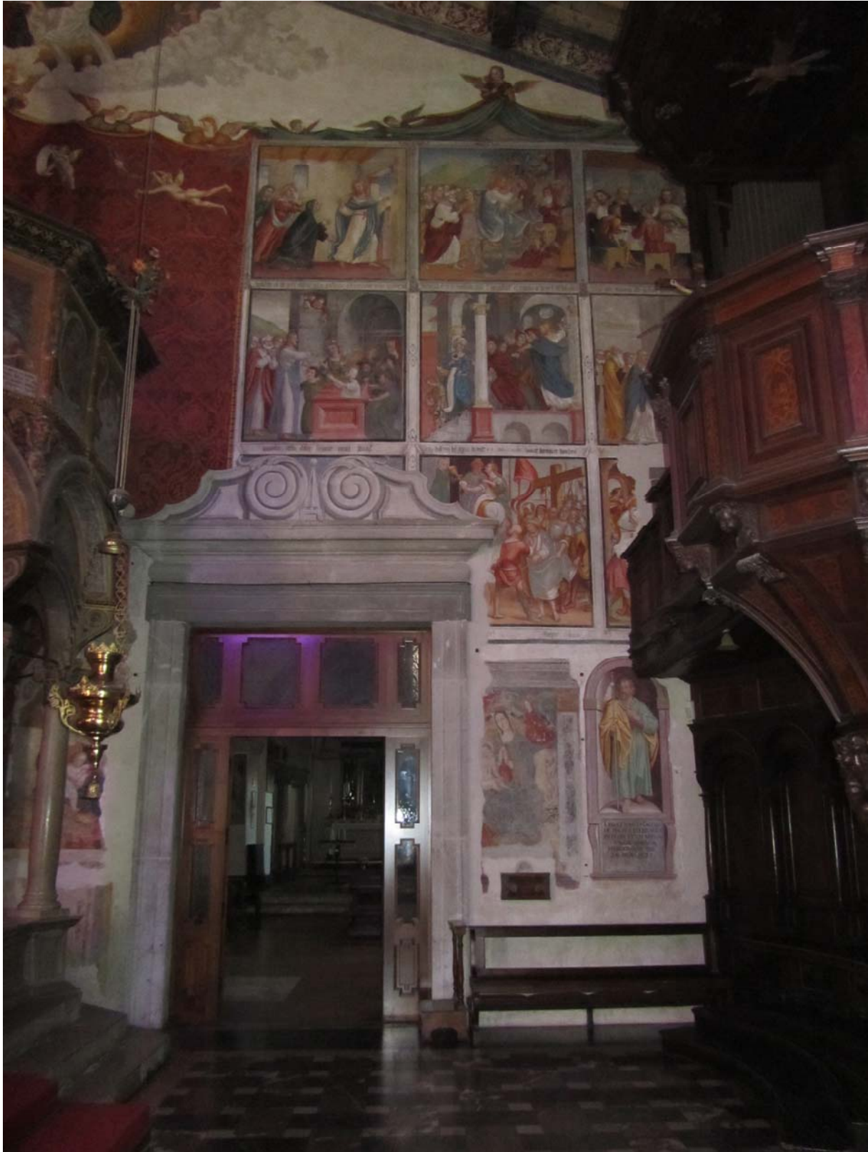
Le passage conduisant de l'église principale à la chapelle du fond. On a tranché dans le mur pour agrandir l'ouverture dont le portail ne doit pas être très ancien. Ces travaux ont gravement nuit aux fresques ici présentes.
